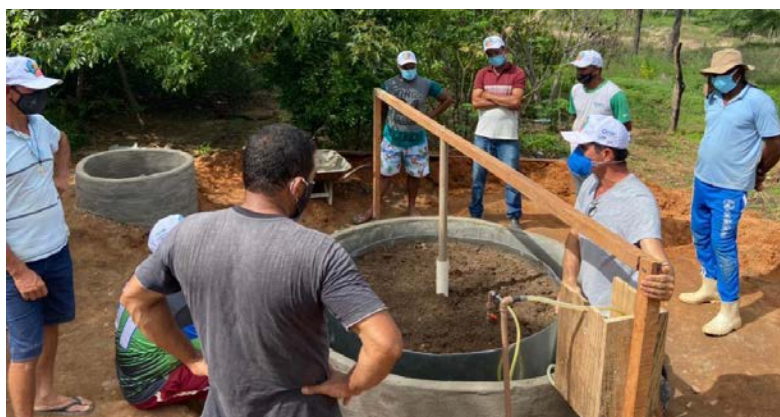
Construção de biodigestores . Fonte: Secretaria de Desenvolvimento Rural do Governo do Estado da Bahia: https://www.bahia.ba.gov.br/2021/05/noticias/desenvolvimento-rural/construcao-de-biodigestores-ira-reduzir-impactos-ao-meio-ambiente-e-gerar-economia-para-familias-do-semiarido/
