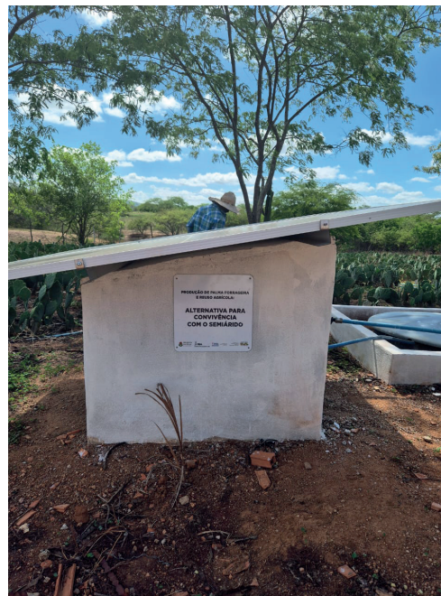
Placas de energia solar do sistema de saneamento e reuso agrícola
